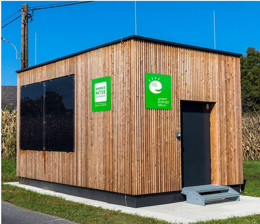
Batteria di accumulo – parte della infrastruttura di Energienetze Steiermark GmbH
